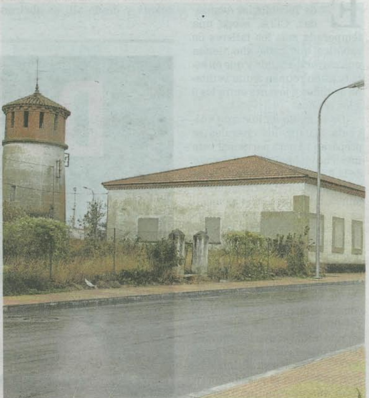
El edificio que albergó la antigua aduana está hoy muy deteriorado./ FOTOS: CASAMAR
