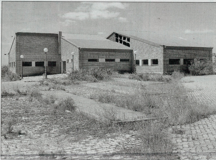
Imagen actual de los edificios de la estación de autobuses oñorense, en total abandono tras invertir un millón de euros.
