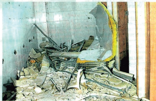
Descorazonadora imagen de uno de los aseos públicos./FOTOS:CASAMAR
